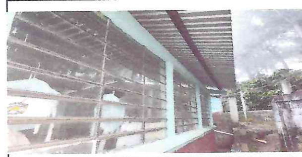
Foto 6: vidrios rotos por falta de balcones
