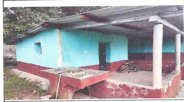
Foto 4: pila en mal estado y no hay piso
