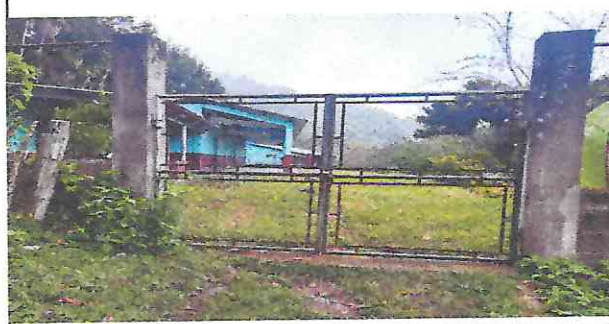
Foto 2: malla dañada del porton
