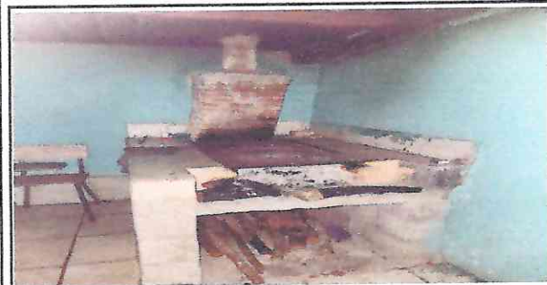
Foto 5: chimenea en malas condiciones
