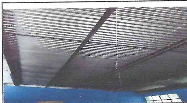
Foto 3: cableado de sistema electro en malas condiciones
